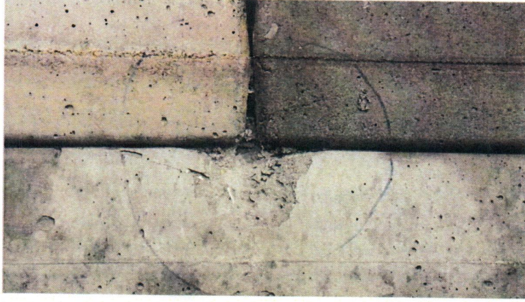
5 metreden atış sonrası duvardaki durum
